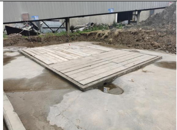
初期雨水池照片
